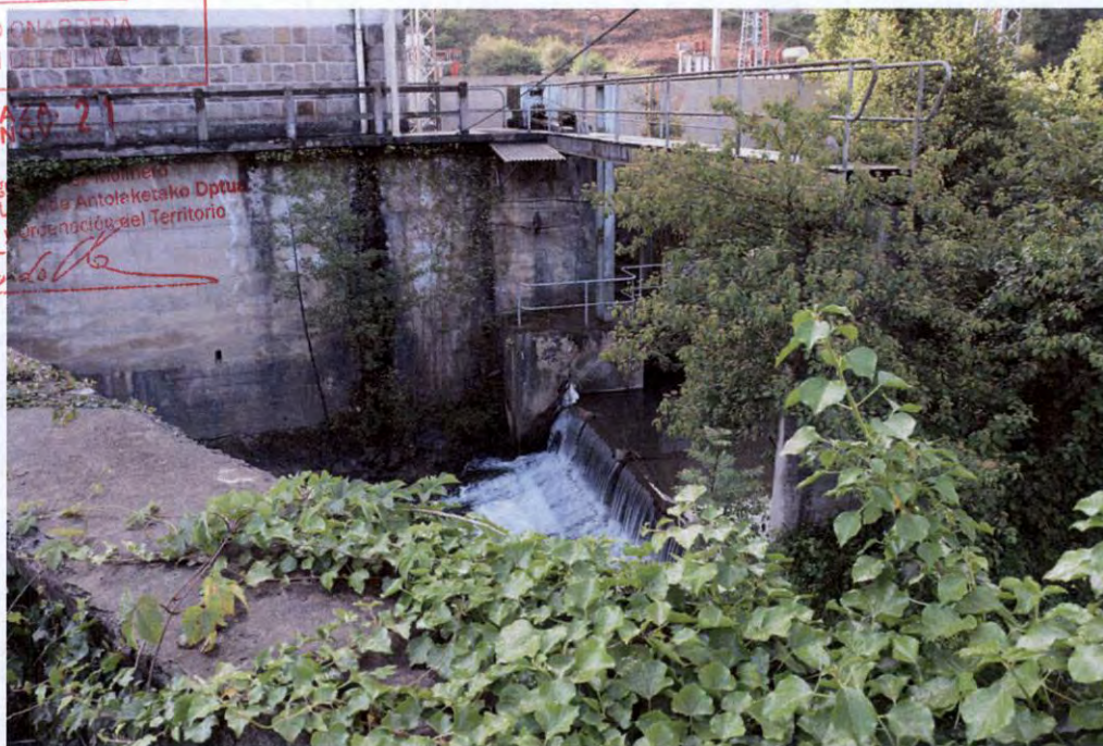
Zona de la pasarela azud de la subestación en el perfil pk 1.098
